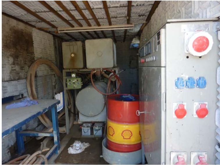
Bild-Nr: 616 Stromezeuger 95 kva im 20 Fuß Container
