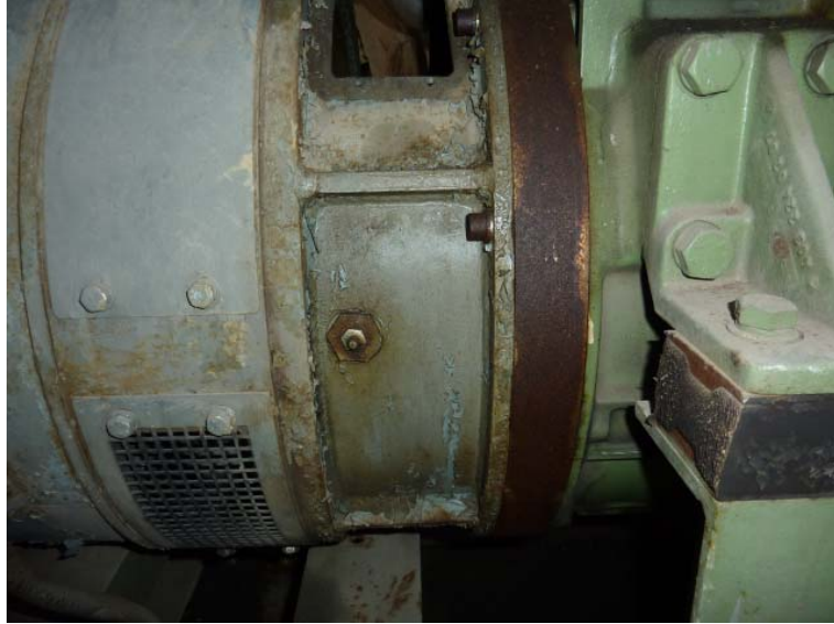
Bild-Nr: 625 Stromezeuger 95 kva im 20 Fuß Container
